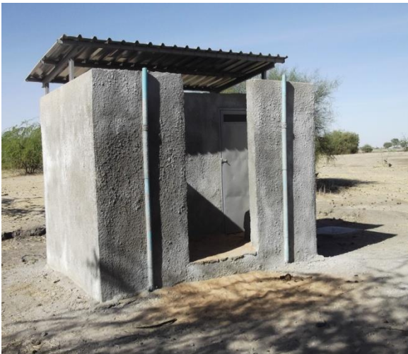
Figure 25 : Latrine de l'école Hamama de N'Djaména-Bilala
