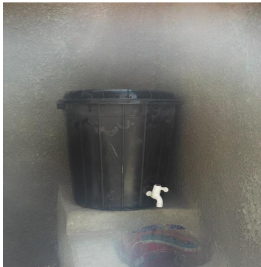
Figure 27 : Dispositif de lave-mains dans une latrine.
